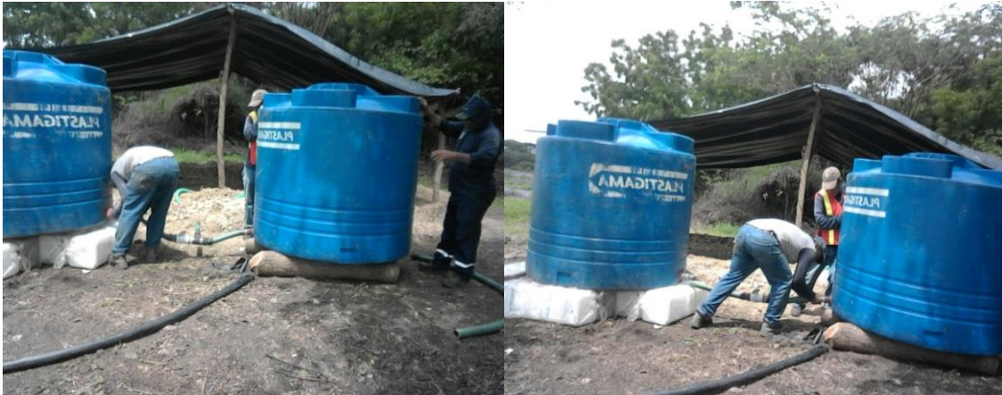
Figura 5. Reservorios temporales del agua residual
