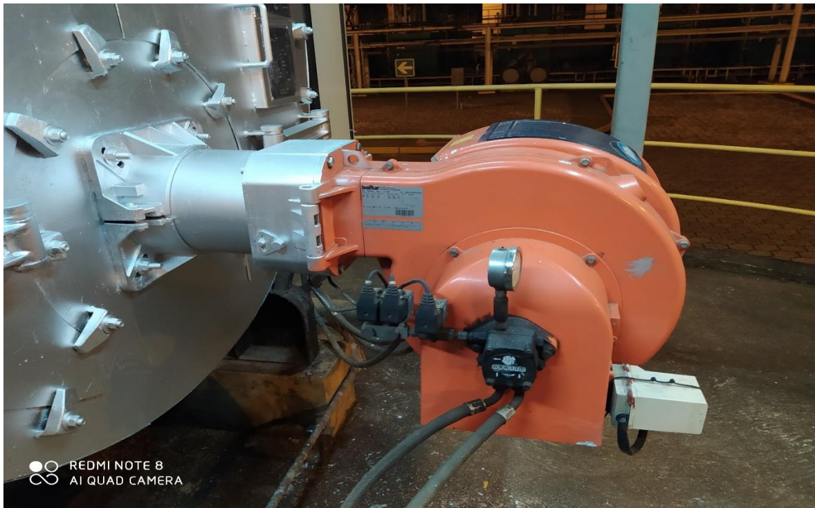
Anexo 9. Quemador del caldero auxiliar.
