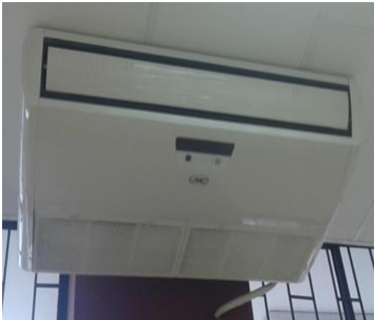
Figura 21. Acondicionadores de aire Piso techo
