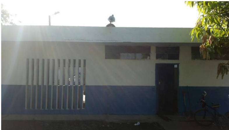
foto 12 Estación de aguas servidas nº 1 de Vines
