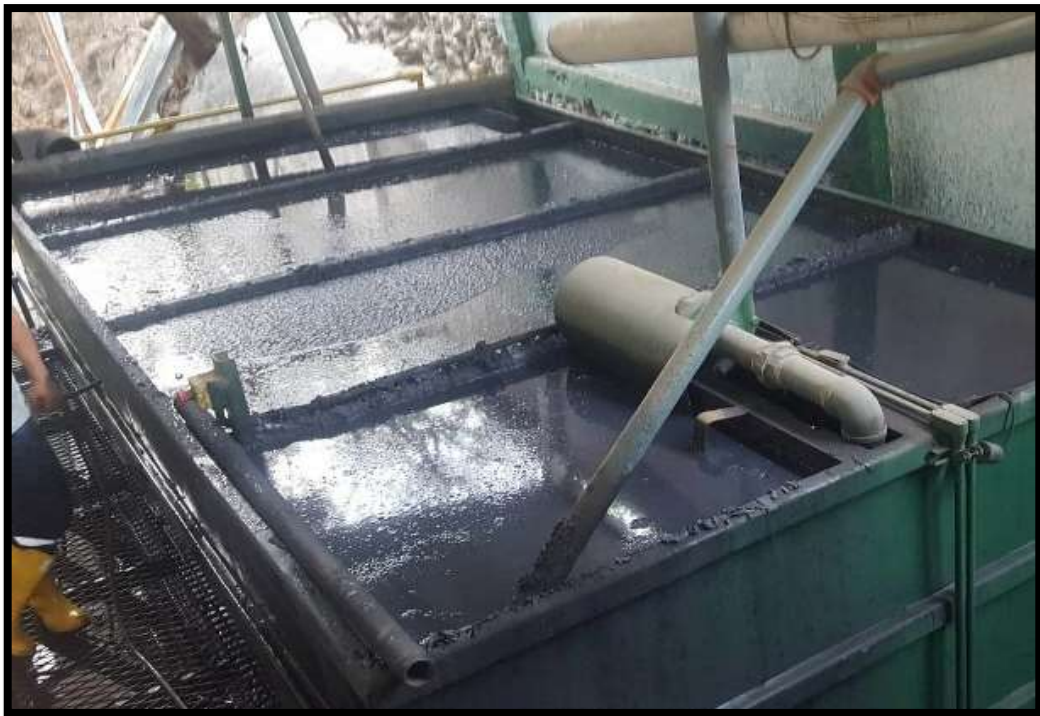
Gráfico 29. Tanque de sedimentación del sistema de tratamiento de agua existente.
