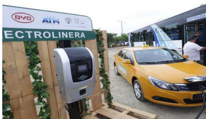
Figura 25. Electrolinera ubicada en la ciudad de Guayaquil.
