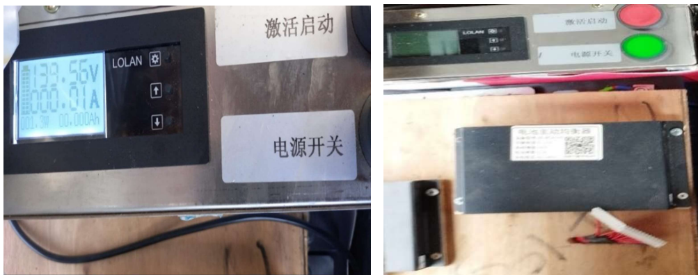
Figura 65. Módulo de control de las baterías
