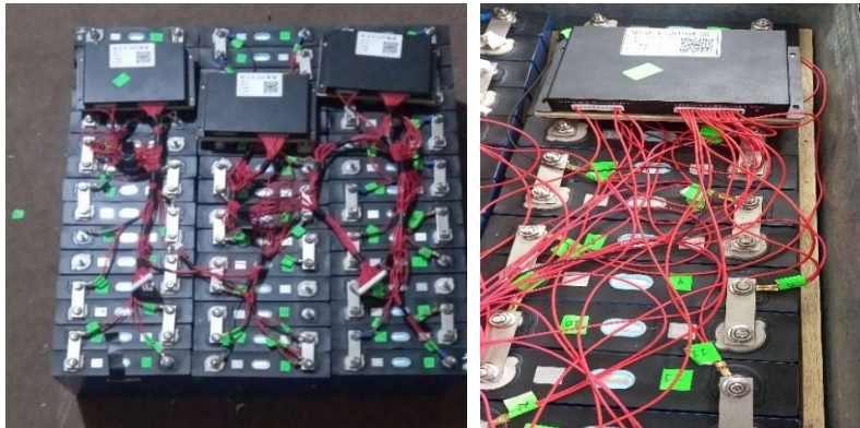
Figura 54. Conexión del BMS y las celdas.
