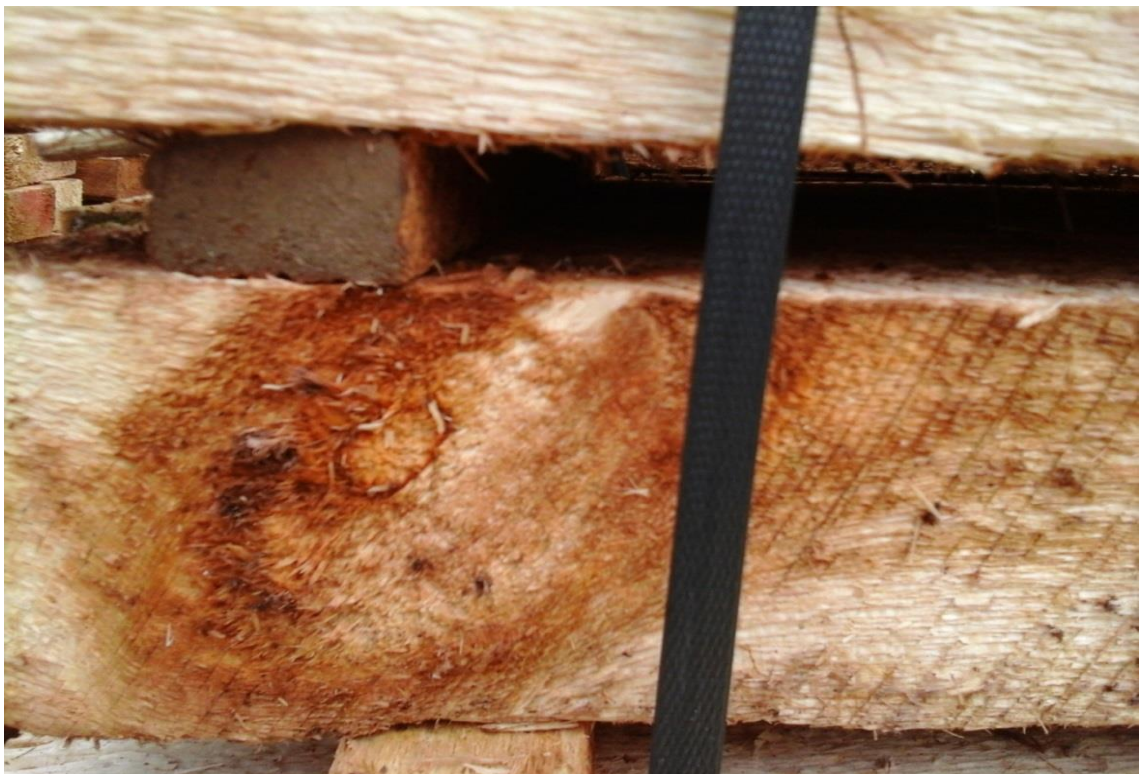
Figura 14. Defectos de madera (Nudo)
