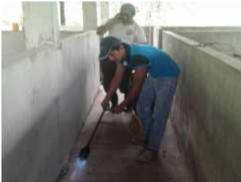
Flameada en el galpón de piso concreto.
