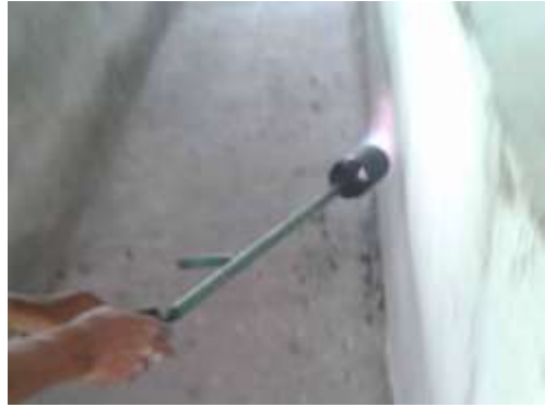
Flameada de las paredes de piso concreto.
