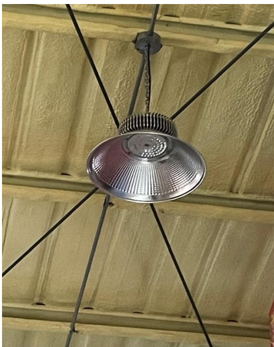
Detección de luminarias con defectos (Luminaria con leds fundidos)
