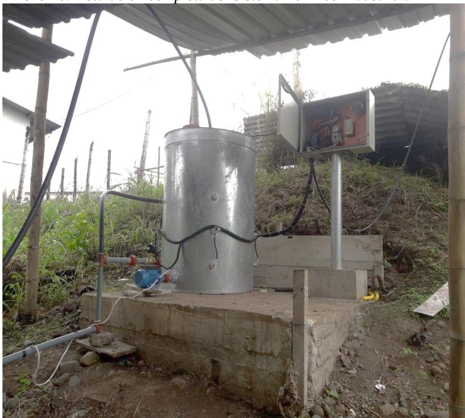
Anexo 16. Instalación completa del Sistema Térmico Industrial.
