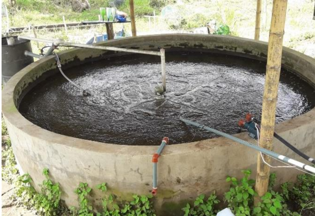
Figura 42. Instalación de carga y descarga del sistema de agua
