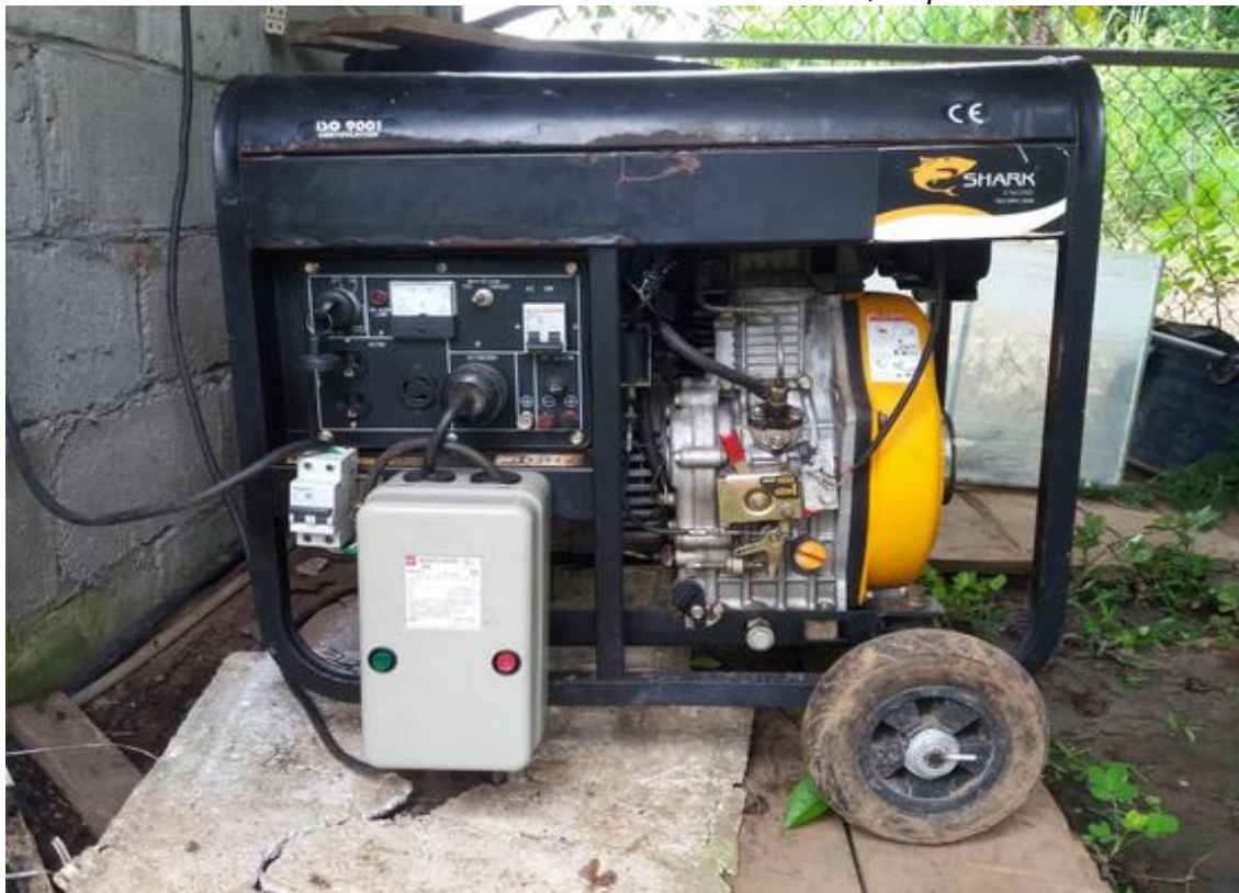
Anexo 19. Generador con su conexión de sistema automático, en funcionamiento
