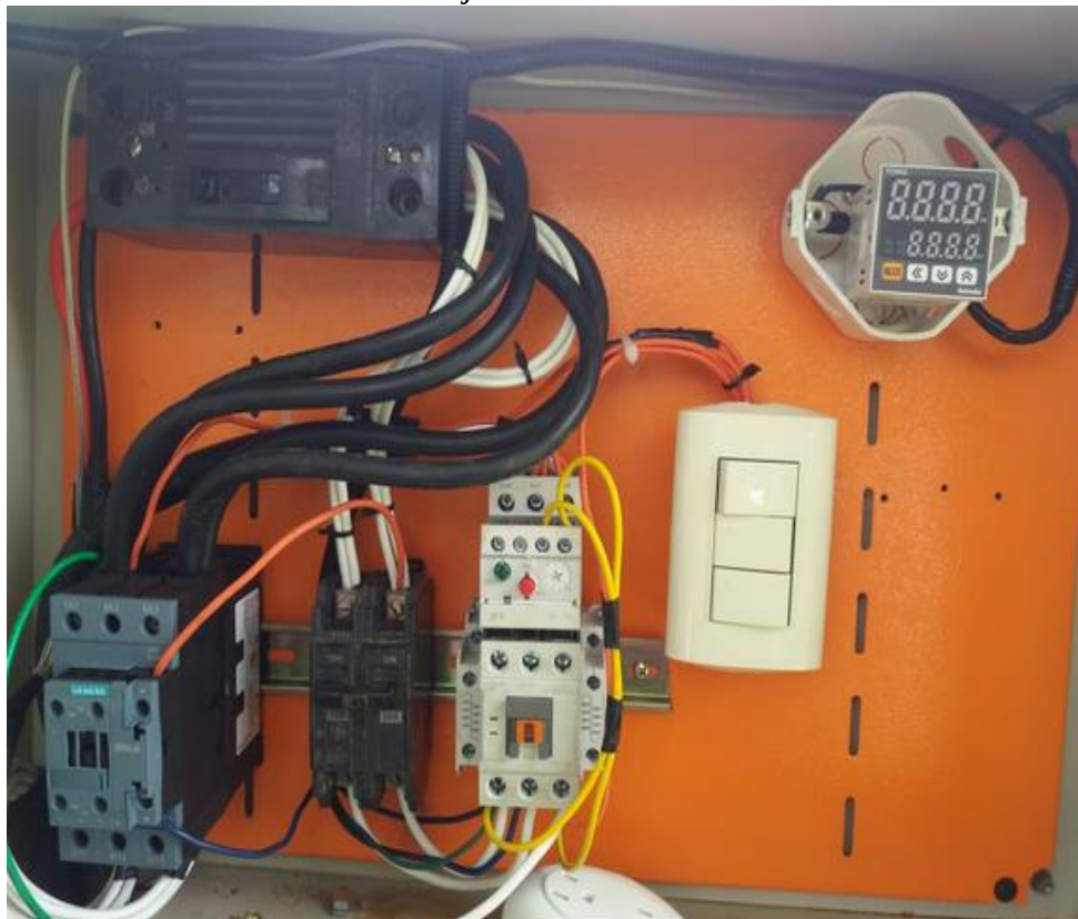
Anexo 15. Instalación de la caja de control del sistema térmico Industrial.
