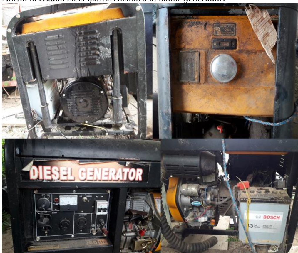
Anexo 6. Estado en el que se encontró al motor generador.
