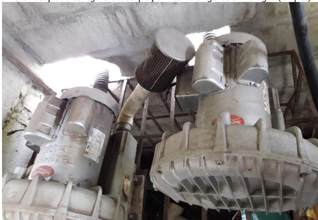
Anexo 4. Sopladores regenerativos que permiten la oxigenación del agua (Biofloc).
