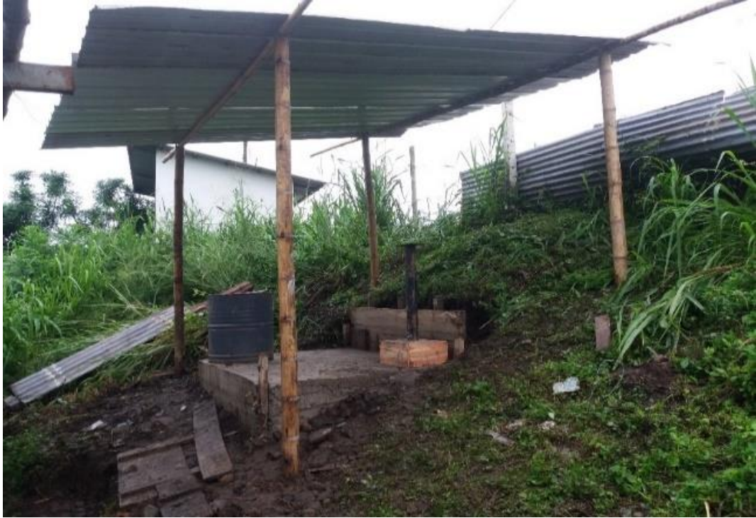
Anexo 11. Adecuación del lugar donde se instaló el sistema térmico industrial.
