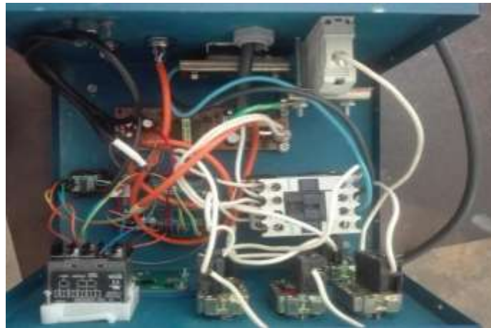
Figura 58. Ensamble interno de la unidad de control.
