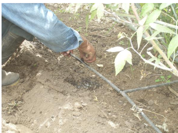
Mantenimiento del sistema de goteo
