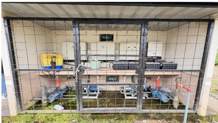
Figura 12. Tablero de control
