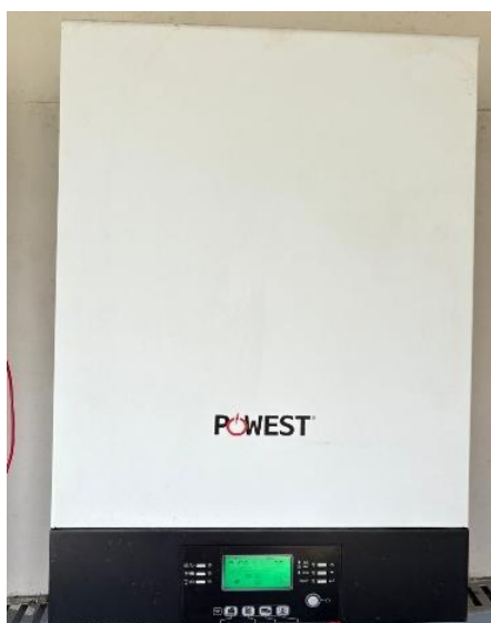
Figura 11. Inversor híbrido instalado en el sistema fotovoltaico
