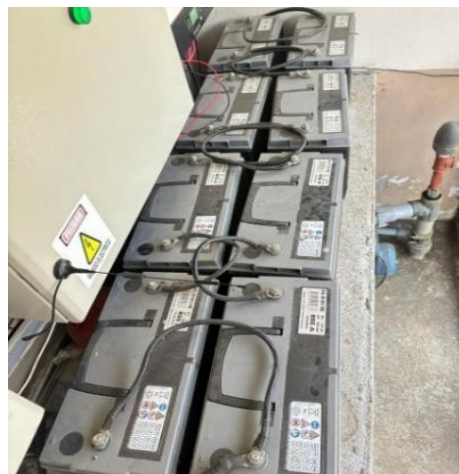
Figura 10. Banco de baterías del sistema fotovoltaico utilizado para almacenamiento de energía
