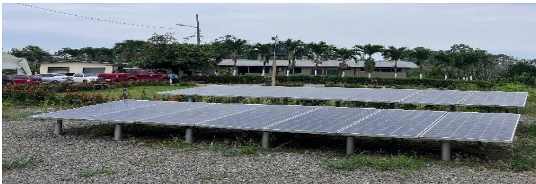
Figura 7. Vista del arreglo fotovoltaico instalado
