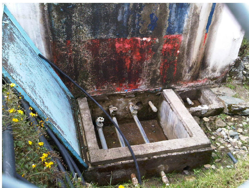
Foto No. 6 Caja y accesorios de salida de la reserva de hormigón ciclópeo
