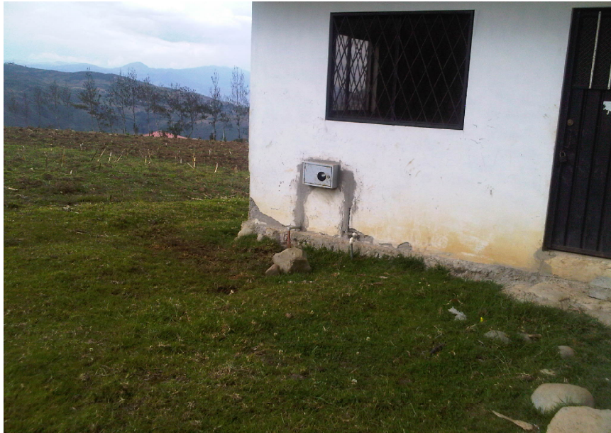
Foto No. 11 Medidor de agua de ½"
