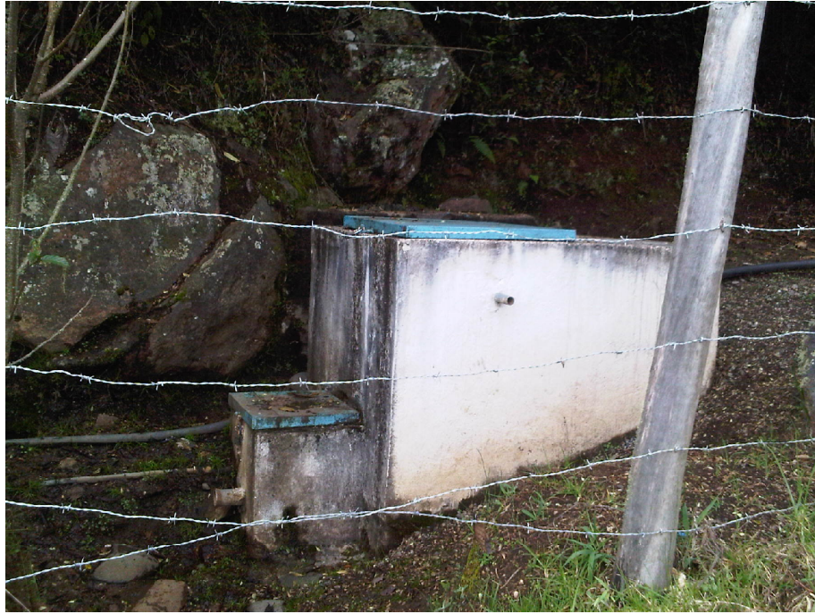
Foto N-19 Captación de Chagchacón 2
