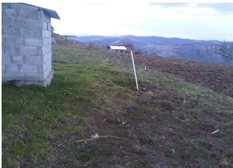
Foto N- 14 Tapas de la fosa séptica de la letrina falladas
