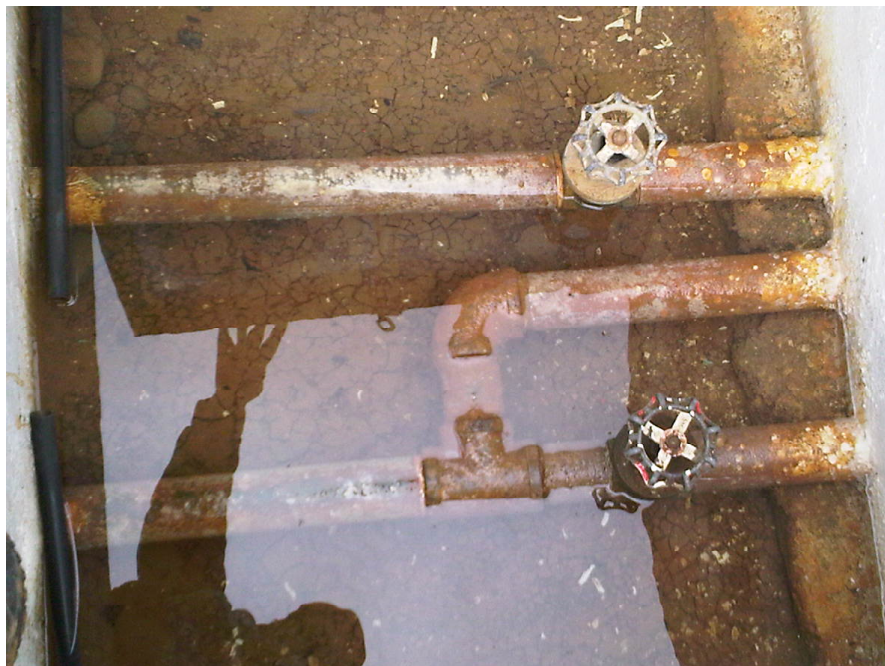
Foto No. 7 Caja y accesorios de salida de la reserva de Ferrocemento
