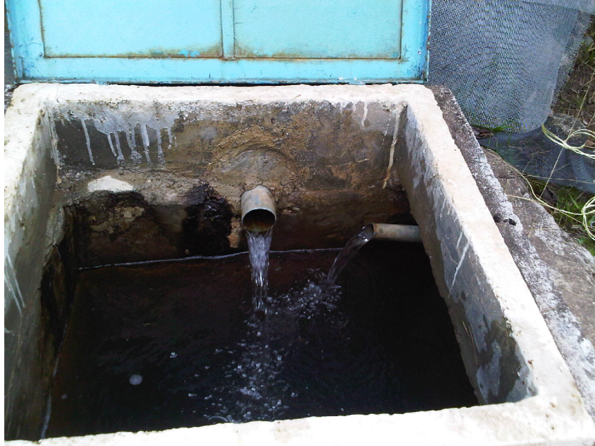
Foto No.1 Tanque recolector de caudales de todas las captaciones
