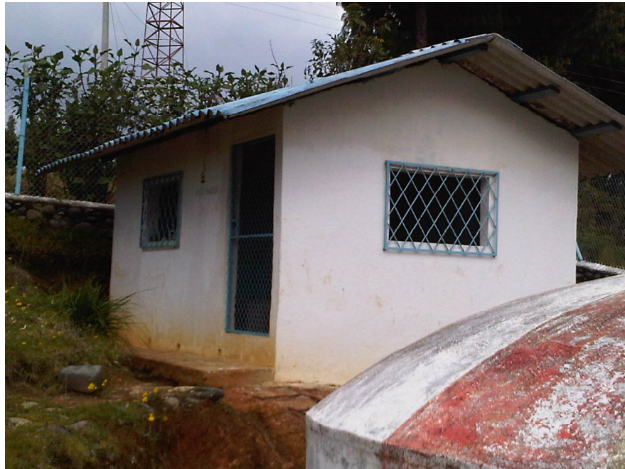
Foto No. 3 Caseta de cloración
