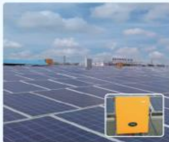
• Rudong, China 1.1MW
