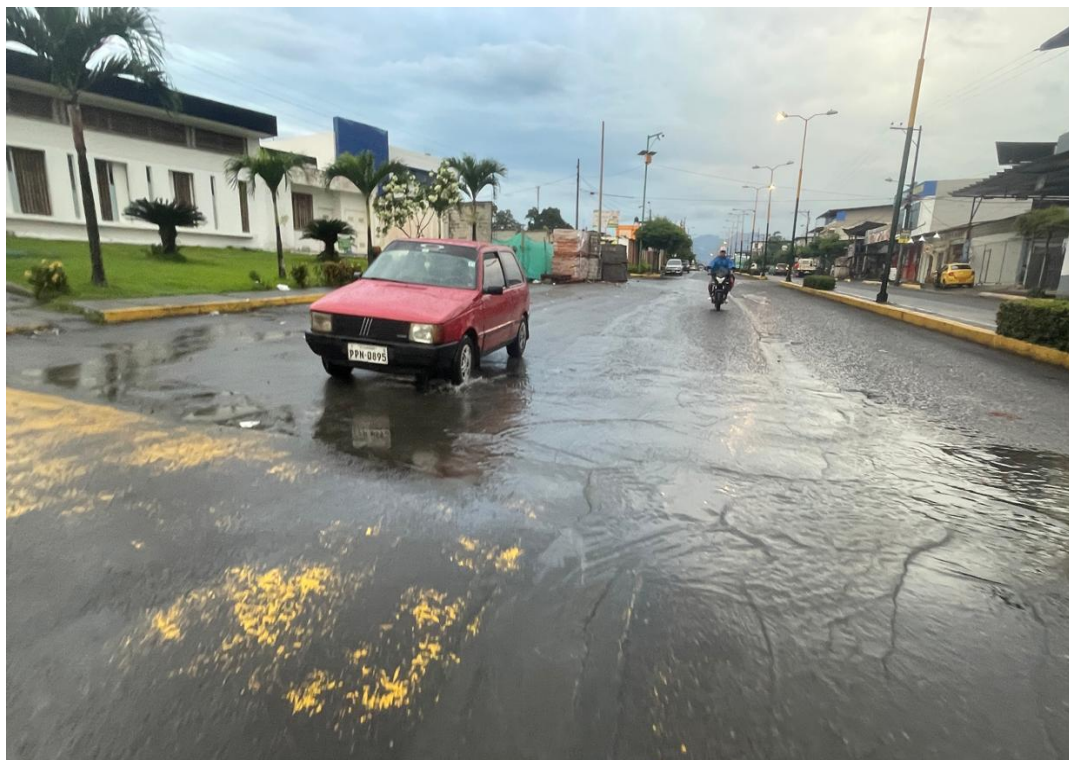
Anexo 10: Estado actual de la vía de ingreso a la zona urbana del cantón Quinsaloma
