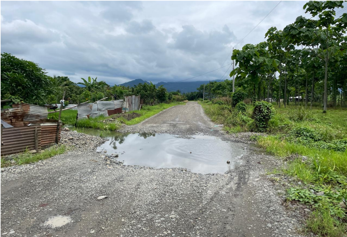
Anexo 8: Ausencia de alcantarilla en la vía Achotillo - Estero de Damas
