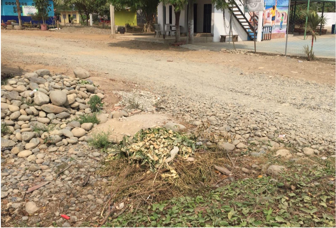
Anexo 7: Zona baja del recinto Estero de Damas presenta ausencia de alcantarillas
