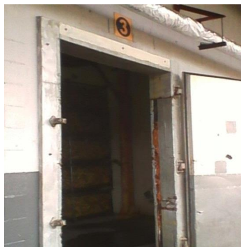
Figura N° 21. Puerta en mal estado
