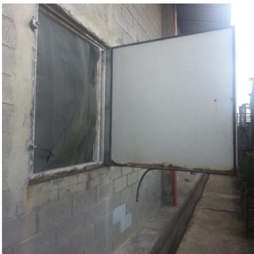
Figura N° 20. Ventana en mal estado
