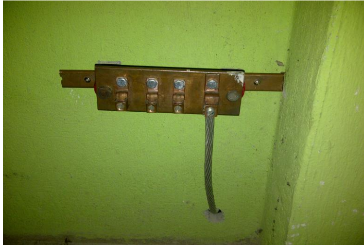
Figura 36: Puesta a Tierra del Proyecto.
