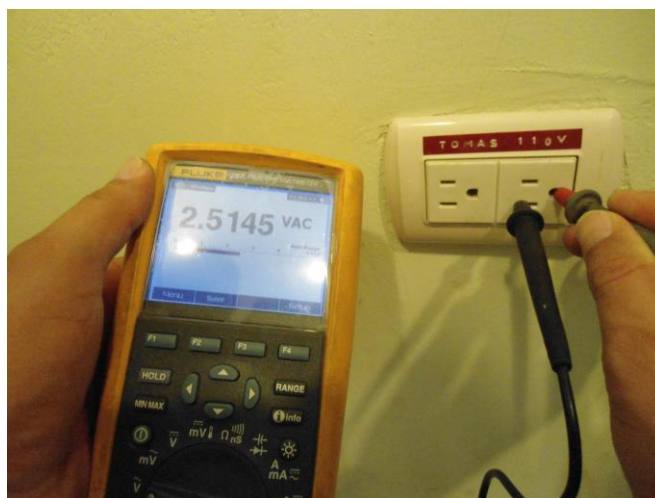
Figura 37: Voltaje medido entre Neutro y Tierra.
