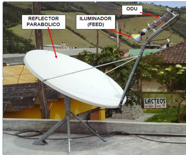
Figura 18: Antena parabólica del terminal VSAT.
