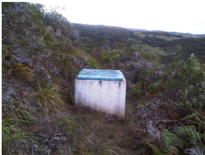
Foto No. 2 Válvula de aire
