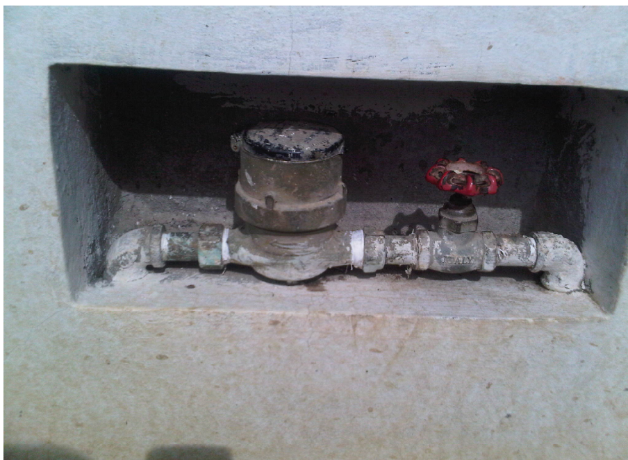
Foto No. 10 Medidor de ½"
