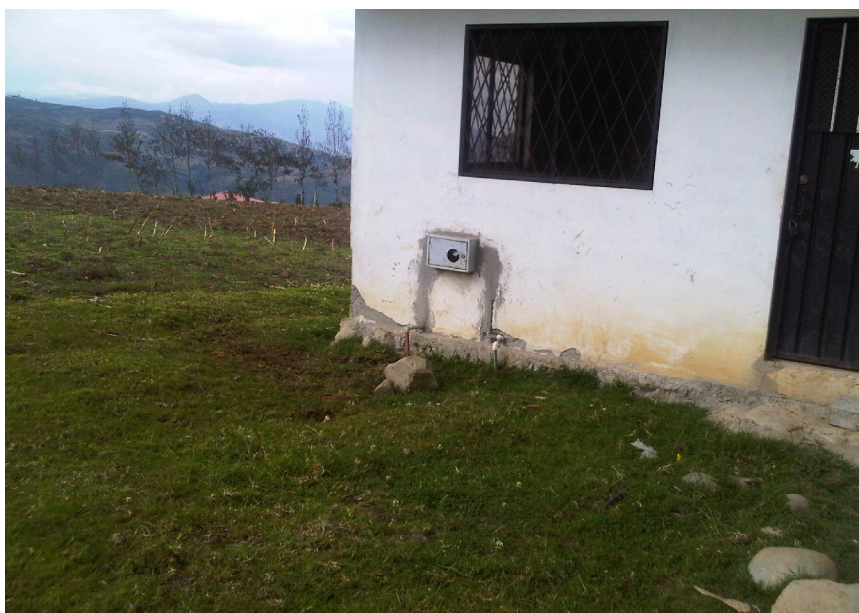
Foto No. 11 Medidor de agua de ½"
