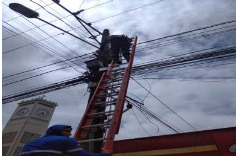
Anexo 1 Instalación de sistema electrónico
