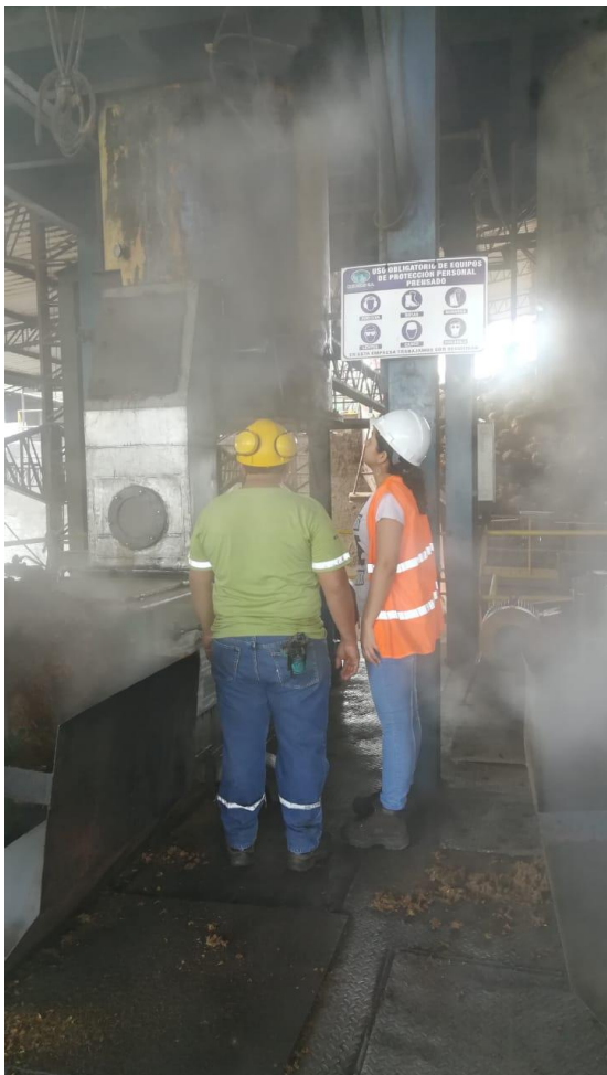
Gráfico # 53 Constatando las fugas existentes en las prensas y digestores
