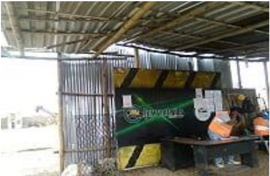
Figura 9. Estructura deficiente en la empresa
