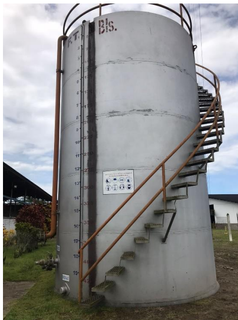
Ilustración 1. Tanque vertical de almacenamiento diésel PR-01.
