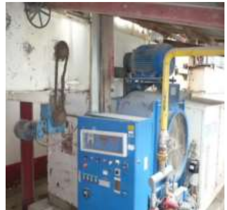
PANEL DE CONTROL TOSTADORA
