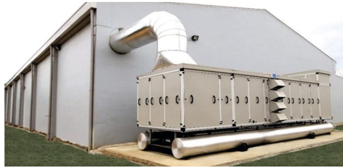
Figura 5. Incubadora de circulación interna con unidad manejadora de aire tipo HVAC [11].
