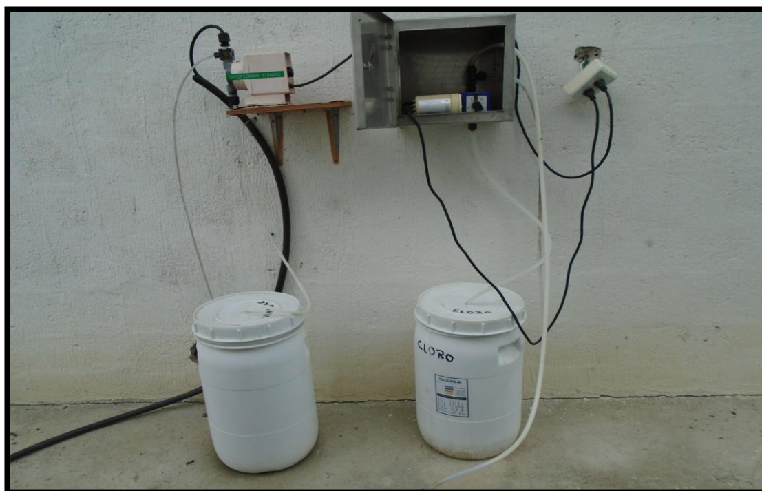
Foto N. 6 Cloración y desinfección de agua Fuente: Granja La Esperanza
