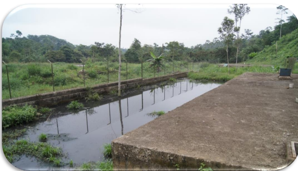
Figura No. 1.7. Planta de tratamiento de aguas residuales (2).
